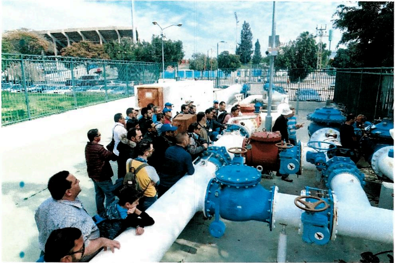
Figura 2: Explicación sobre funcionamiento de dispositivos estación de bombeo Tel Avid Fuente: UEP RANC-EE, 2018.
