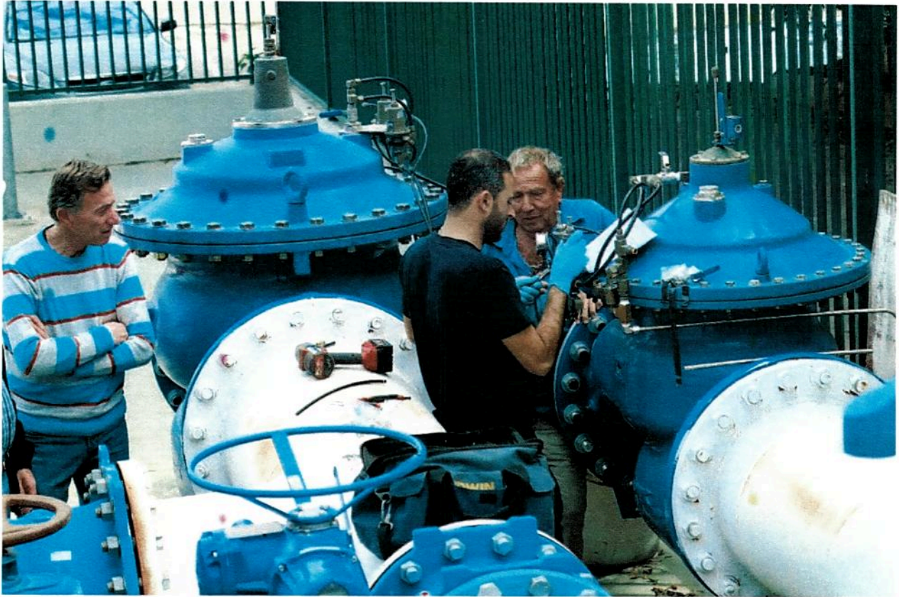
Figura 1: Armado de dispositivos en estación de bombeo Tel Avid Fuente: UEP RANC-EE, 2018.
